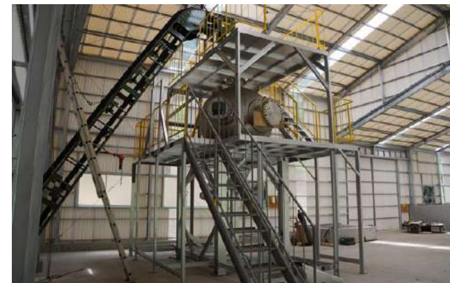
本体設置状況
